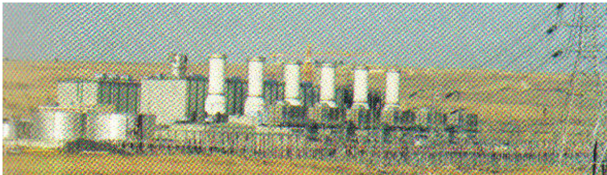
Obr. 1.412 Elektráreň v Ambarli [21]
